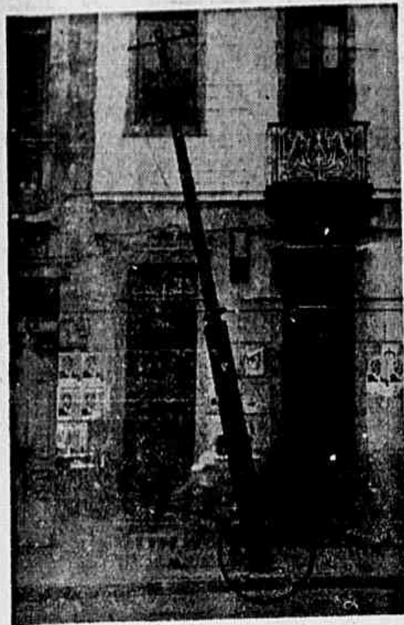
Este poste está a cair, pois sua base está corroída pela ferrugem. É uma ameaça à vida dos transeuntes. Ele sustenta fios telefônicos e está situado junto à porta do número 6, da Rua dos Arcos e não é o único que se encontra nesta situação, o que demonstra o descaso criminoso que a Companhia Telefônica (Light), tem pela vida do povo.
