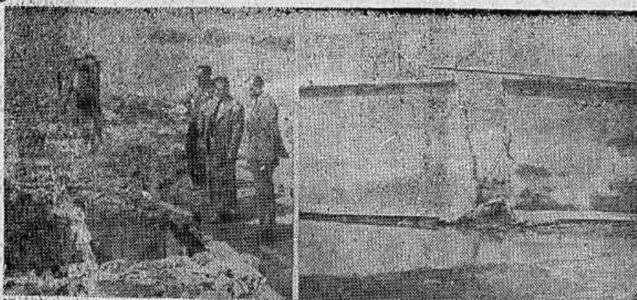
Nas fotos acima aspectos do acidente, vendo-se a parede da adutora rachada de alto e baixo e à esquerda o prefeito Alim Pedro observando operários trabalhando na limpeza da área danificada
