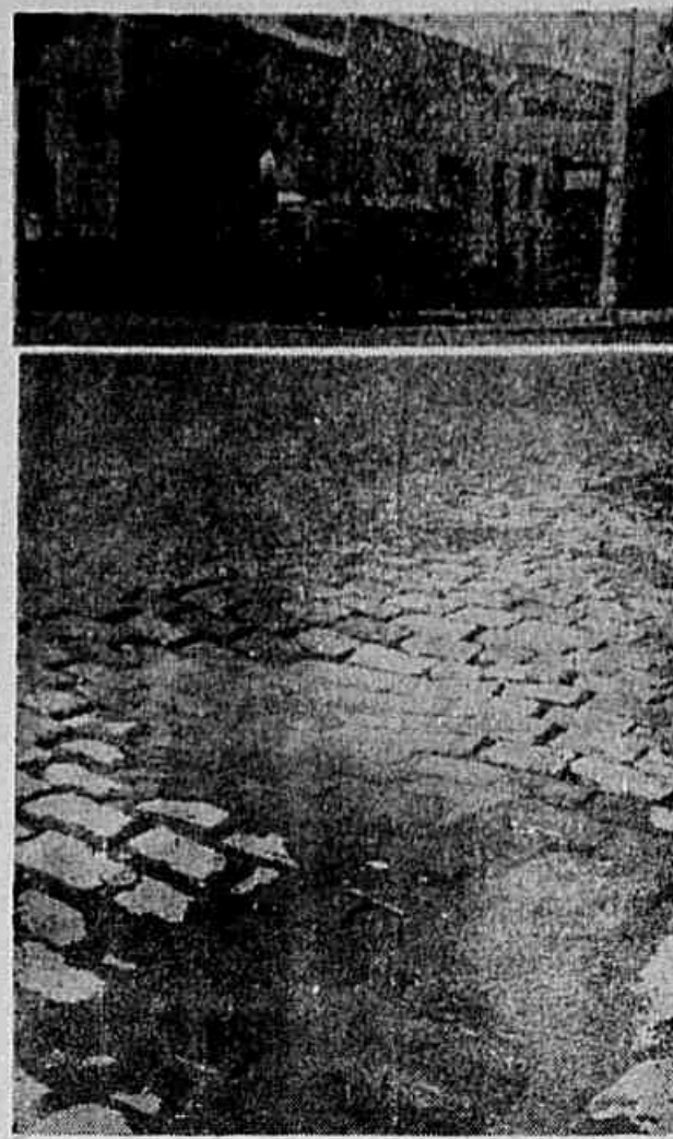
Centenas e centenas, talvez milhares, de vazamentos iguais a este, causados pelo péssimo estado da rede de distribuição fazem com que quarenta em cada cem litros de água fornecidos ao Rio seja desperdiçada antes de chegar às residências. (Na foto vazamento na esq. de Suburbana com Democráticos)
